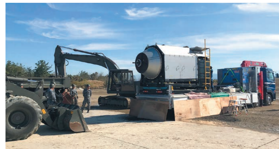
写真中央が「移動式廃アスファルト再生機」。はぎ取った舗装を銀色の窯の部分で加熱する。添加剤を補うことで耐久性のある材料となり、産業廃棄物やCO2の発生も抑制できる
